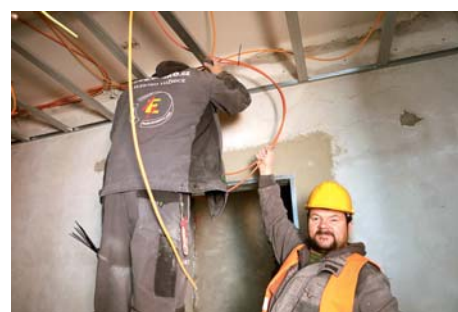
Rozvod elektrických kabelů.
